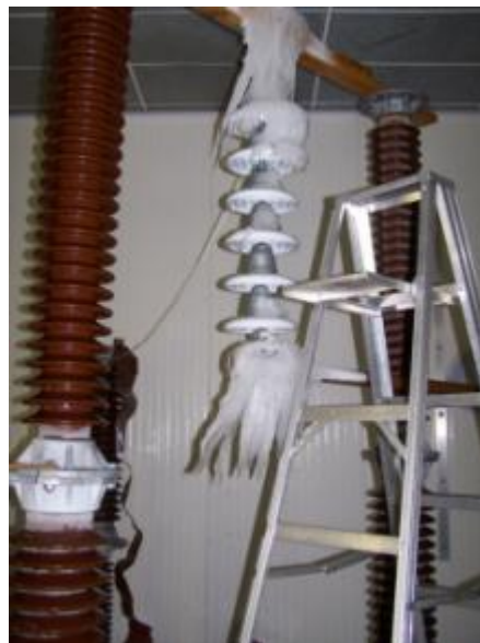
Figure 19 : Chambre réfrigérée pendant le dégel
