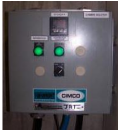
Figure 12 : Système de contrôle de la température
