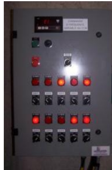
Figure 14 : Système de ventilation
